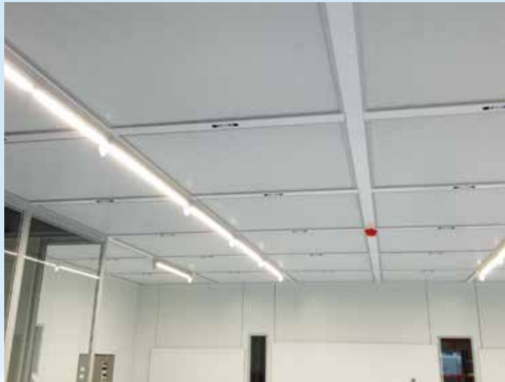
Das Filter Fan Unit (FFU) im Einsatz
