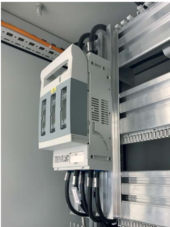
Abb. 1: Hauptschalter auf RG035.
