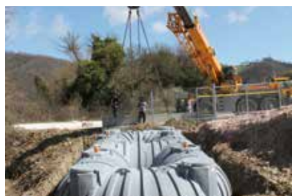
Water storage for firefighting (75m³). Stockage d'eau pour réseau incendie (75m³).
