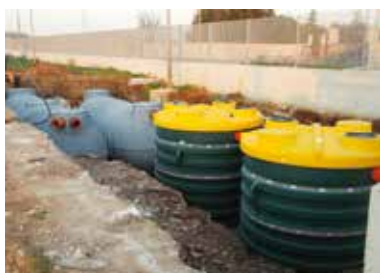
Stormwater runoff treatment (35 l/s). Installation de première pluie (35 l/s).
