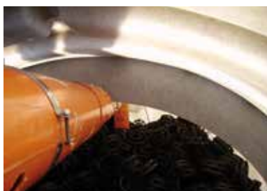
Anaerobic percolating filter. Filtre percolateur anaérobie.
